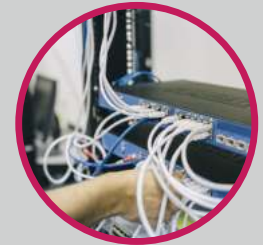
Elektro-, Fernmelde- und Aufzugstechnik
